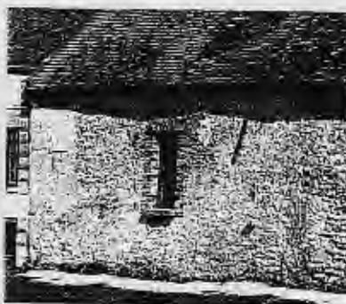
On s'interdit l'emploi d'enduits au ciment : ici le mur est dénaturé par les
